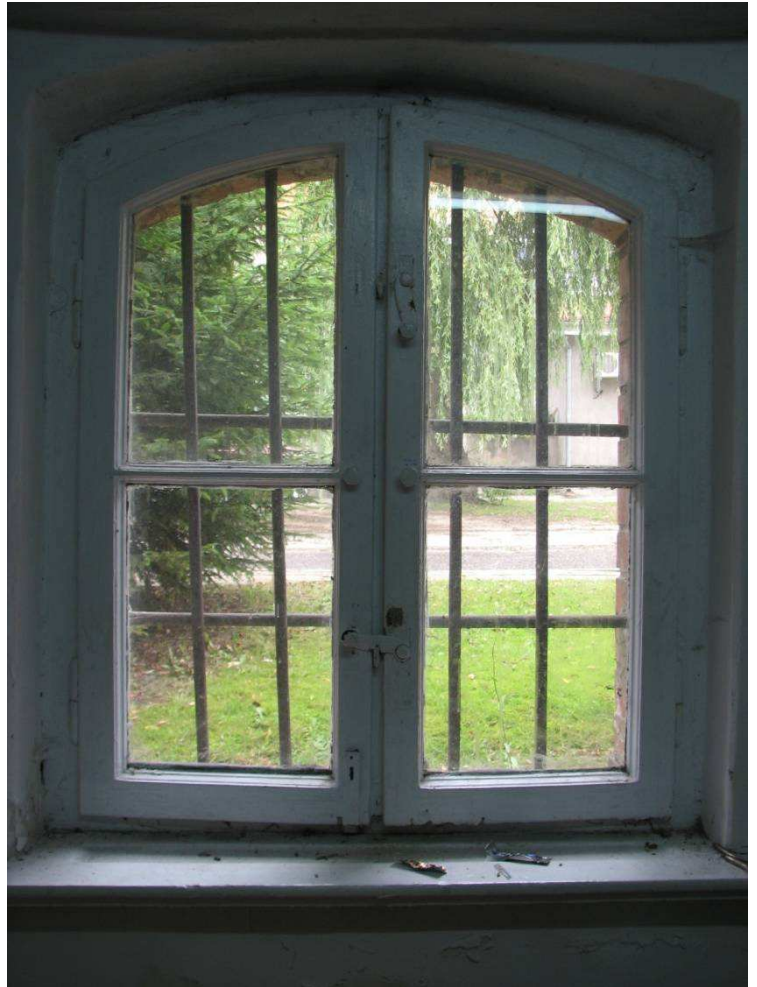
Fot. 9 Olsztyn, Kortowo, Plac Łódzki 2, stolarka okienna typ O3, widok od wewnątrz
