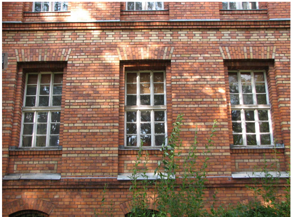
Fot. 18 Olsztyn, Kortowo, Plac Łódzki 2, stolarka okienna typ O7, widok od zewnątrz
