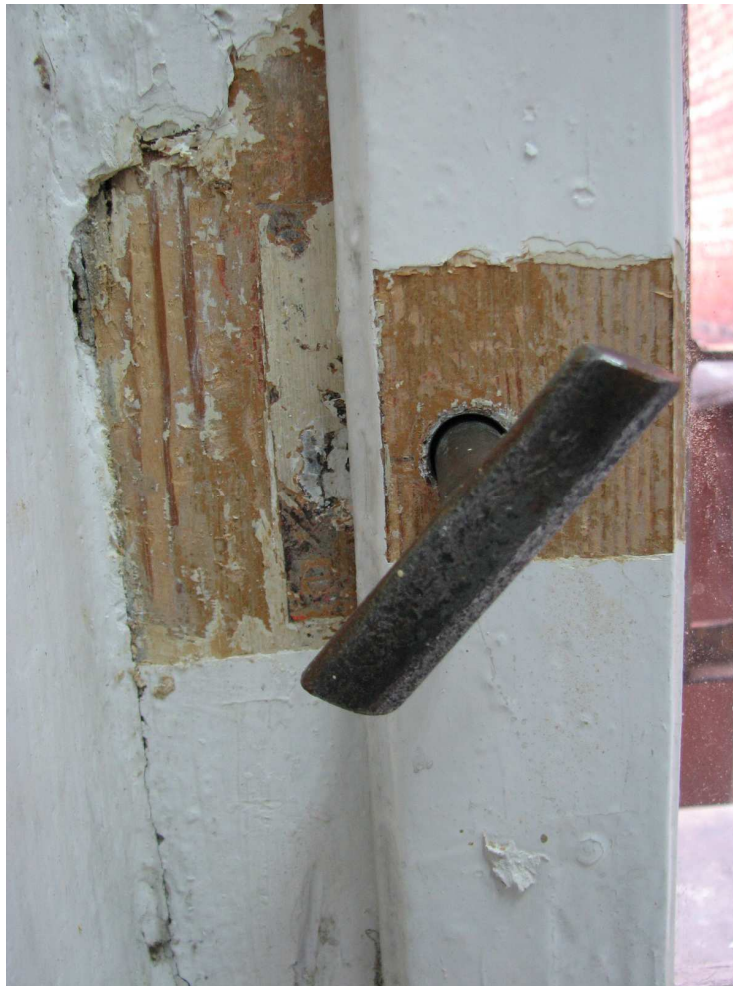
ODKRYWKA 13 skrzydło okienne, widoczny mazerunek w kolorze jasno ugrowym
