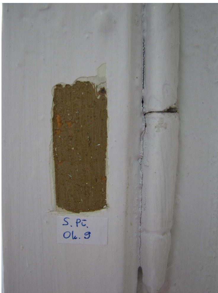
ODKRYWKA 8 Ramiak skrzydła, widoczny mazerunek w kolorze ugrowym
