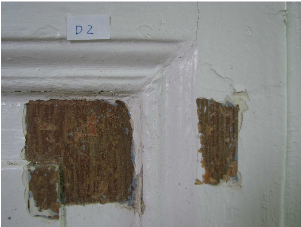
ODKRYWKA 19 Dz2 Skrzydło drzwiowe strona wewnętrzna, widoczny mazerunek w kolorze ugrowo- brązowy
