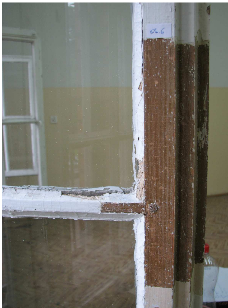
ODKRYWKA 4 Ramiak oraz szpros skrzydła wewnętrznego, widoczny mazerunek w kolorze brązowo- ugrowym
