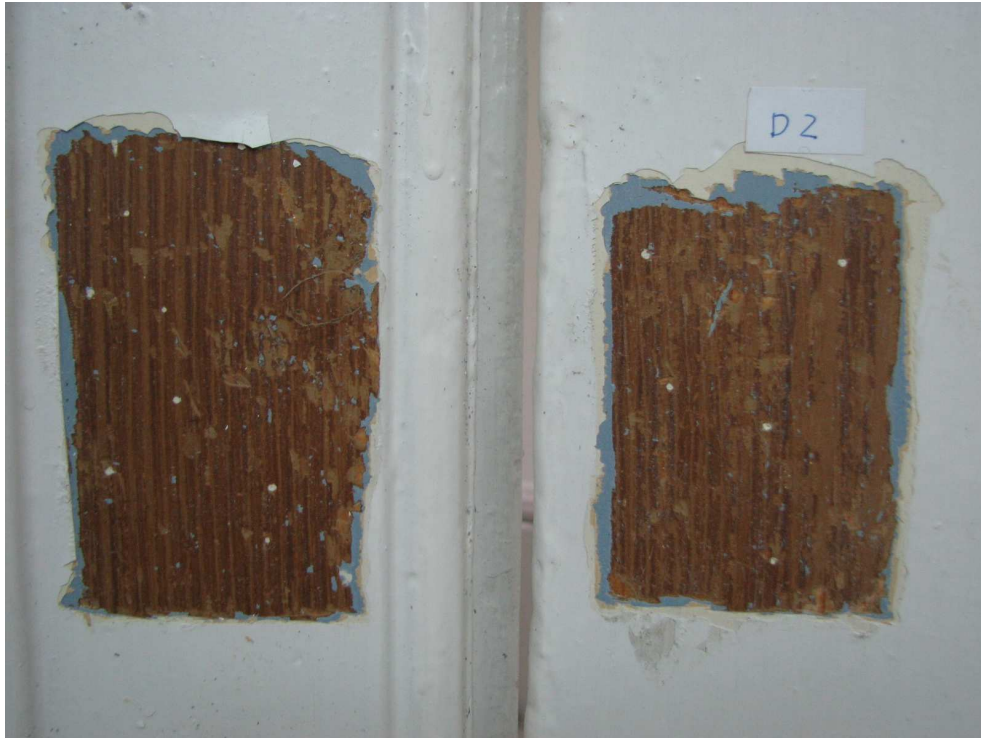
ODKRYWKA 18 Dz2 Skrzydło drzwiowe i ościeżnica strona zewnątrzna, widoczny mazerunek w kolorze ugrowo- brązowy
