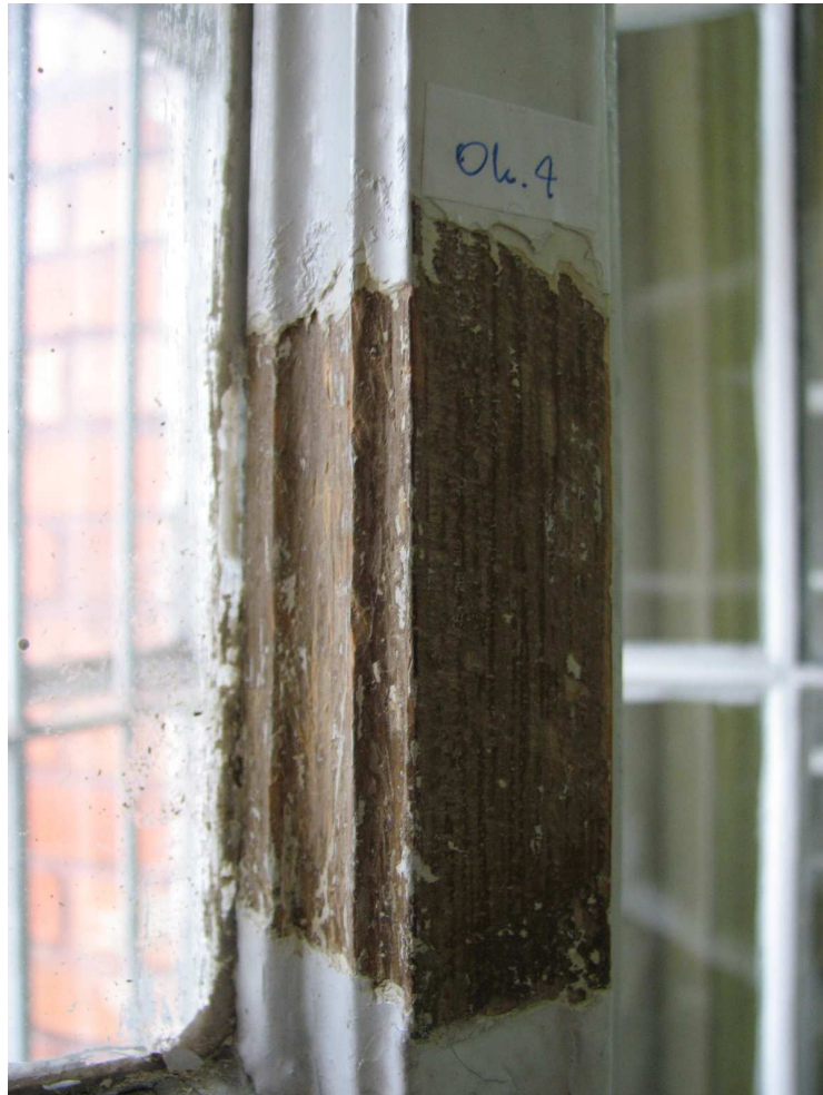
ODKRYWKA 2 Ramiak oraz profil skrzydła wewnętrznego, widoczny mazerunek w kolorze brązowym
