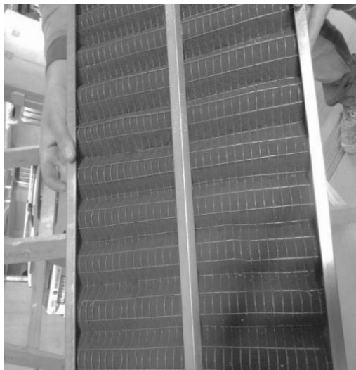
Rysunek 4. Widok brudnego filtra wentylacyjnego
