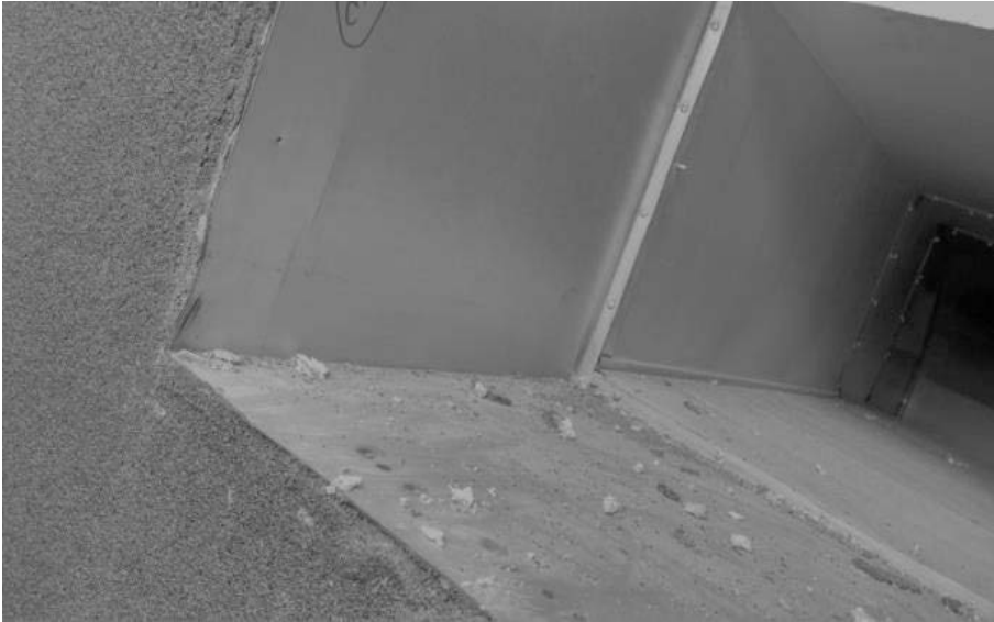
Rysunek 1. Widok zapyłonego przewodu wentylacyjnego
