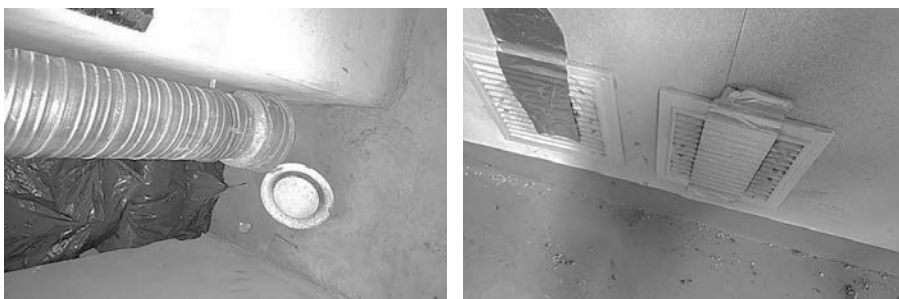
Rysunek 7. Widok zdemontowanego anemostatu wyciągowego w garażu oraz zaklejonych kratki transferowych
