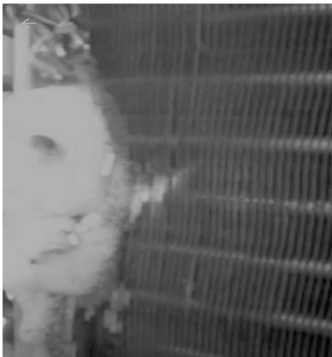
Rysunek 6. Widok zniszczonych lamel agregatu sprężarkowego układu Multisplit
