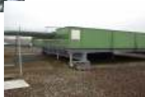
biofiltry do dezodoryzacji gazów odlotowych
