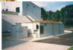
biofiltry do dezodoryzacji gazów odlotowych
