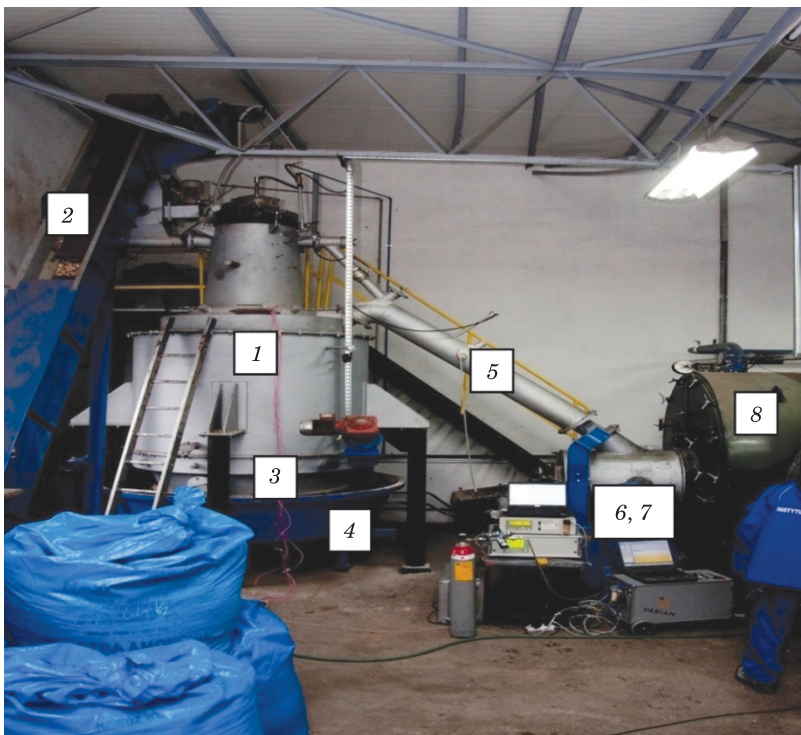
Fot. 1. Instalacja zgazowywania biomasy: 1 – reaktor zgazowania-przeciwprądowy (gazogenerator) o mocy 500 kW z ciągłym podawaniem paliwa, uszczelnieniem wodnym i mechanicznym odbiorem popiołu, 2 – podajnik biomasy, 3 – stożek odprowadzania popiołu z dyszami powietrza dopalającego, 4 – wanna uszczelnienia wodnego, 5 – rurociąg gazu, 6 – palnik gazu procesowego, 7 – palnik pilotowy olejowy, 8 – kocioł wodny
