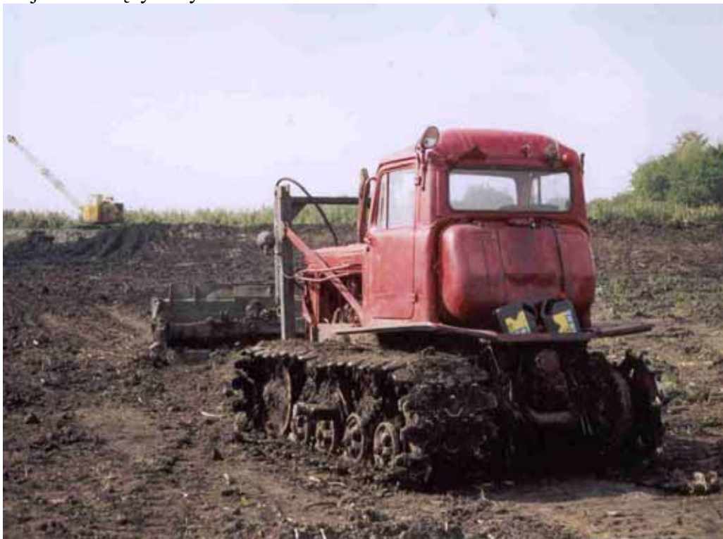
Fot. 25. Faza budowy stawu karpiowego, kształtowania dna oraz grobli, przypomina nieco krajobraz księżycowy.
